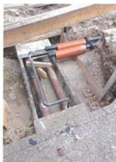
Lecsatlakozás a gerincről
