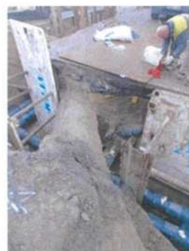
Meglévő és felhagyott egyéb közművek a járdában és a távhővezeték
