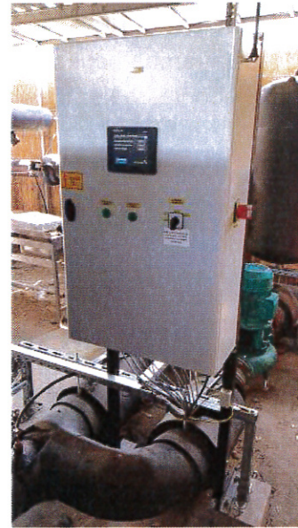
23. ábra: Heim Pál Kórház hűtőgép vezérlő szekrény
