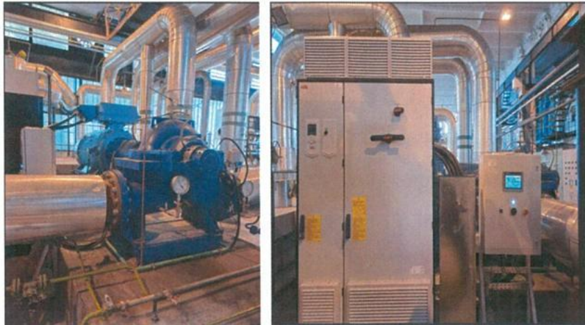
23. ábra Fűredi u. fűtőmű KS2 szivattyú frekvenciaváltós szabályozó
